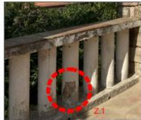
Pèrdues de la capa de revestiment
