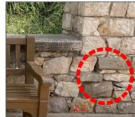
Pèrdua de material de rejuntat
