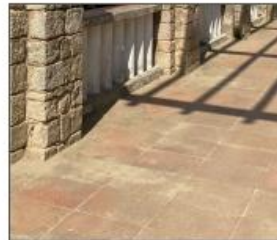
Degradació del paviment
