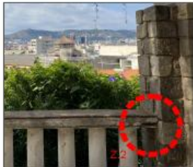
Esquerdes i trencament de la balaustrada
