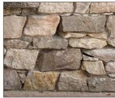
Z.3 - Erosió i pèrdua de material a les juntes del parament de pedra, amb rebaix superficial que deixa les juntes endinsades respecte al pla del mur.
