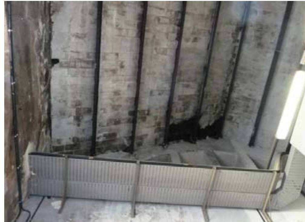
HUMITATS AL SOSTRE PER FILTRACIONS DE LA COBERTA.
