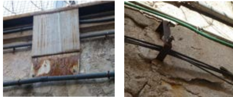
PATOLOGIES PER OXIDACIÓ DELS ELEMENTS METÀL·LICS
