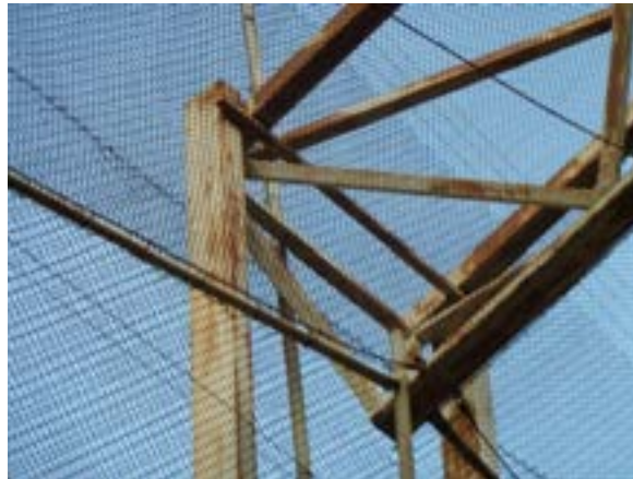
LES ESTRUCTURES DE SUPORT DE LES XARXES ESTAN TOTES OXIDADES.
