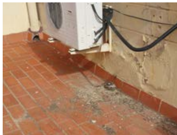
DETERIORAMENT TERRASSA DEL PATI.
