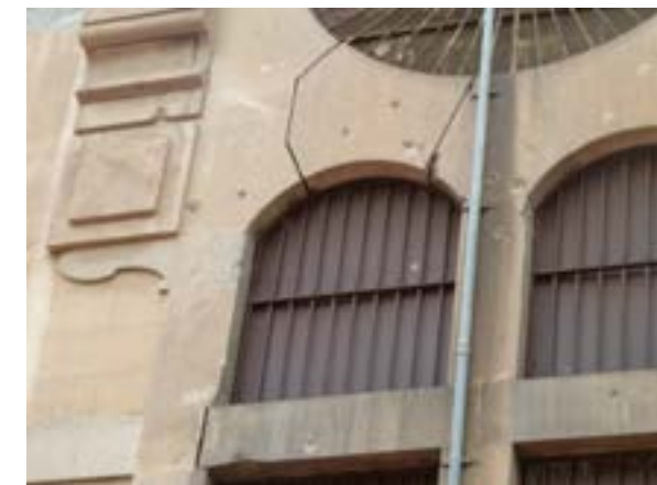
BLOCS DE PEDRA DELS TESTERS DESENCAIXATS.
