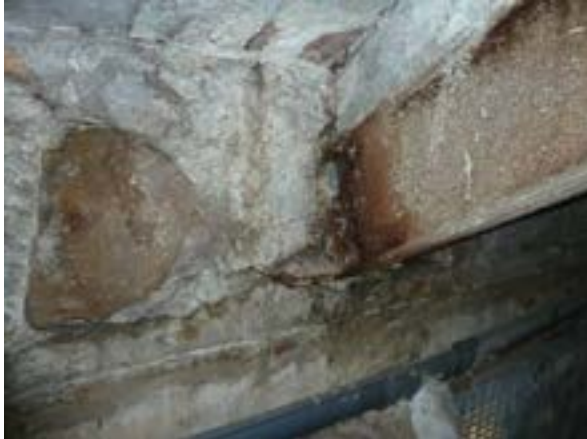
CAP DE LA BIGA DE COBERTA OXIDAT
