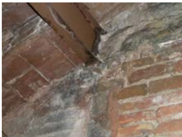
OXIDACIÓ PERFILS SOTACOBERTA.
