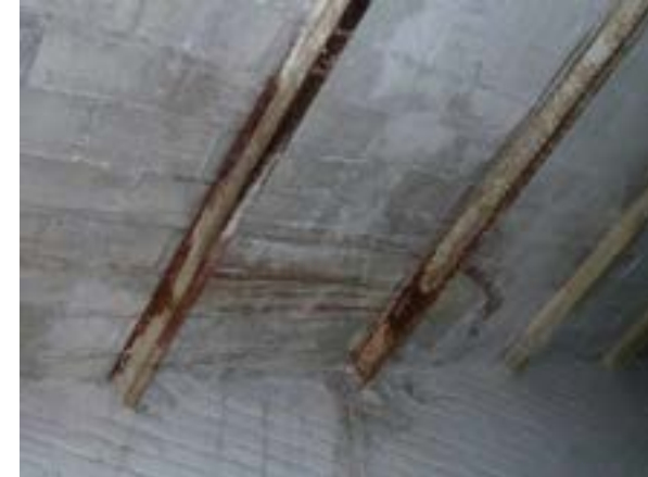
LES OXIDACIONS SÓN MÉS GREUS A LES ZONES AMB MAJORS FILTRACIONS.
