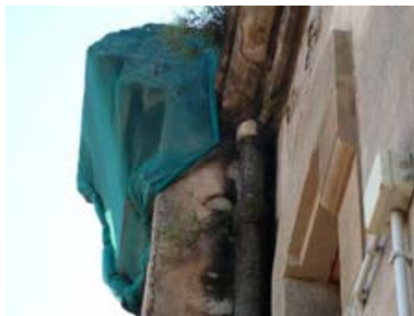
PROTECCIÓ DELS DESPRENIMENTS DE LES CORNISES..
