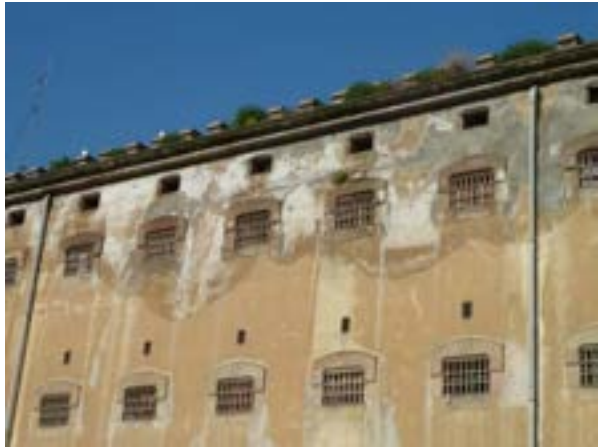
HUMITATS PROVINENTS DE LES CANALS OBSTRUÏDES.
