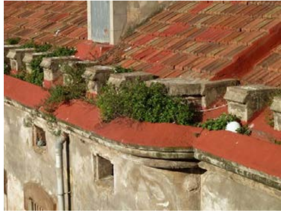
ESTAT DE LES CANALS DE LES GALERIES DE CEL·LES.
