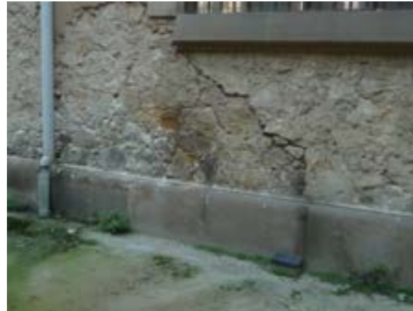
ESQUERDES A LA BASE DELS MURS.
