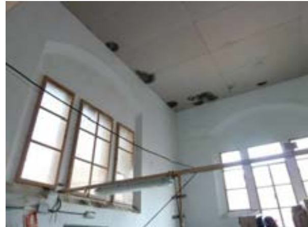
HUMITATS PER FILTRACIONS DE LA COBERTA.
