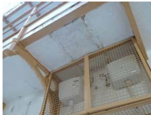
OXIDACIONS ALS PERFILS DELS PASSADISSOS.
