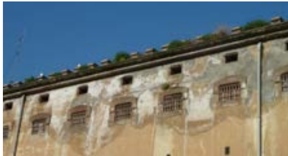
HUMITATS PROVINENTS DE LES CANALS OBSTRUÏDES.
