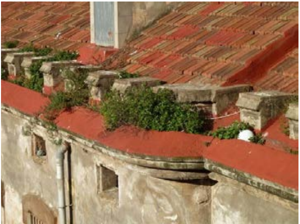
HUMITATS PER OBSTRUCCIÓ DELS CANALS.
