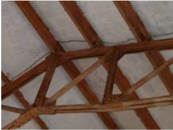
OXIDACIÓ A LES ENCAVALLADES DE LA BUGADERIA.
