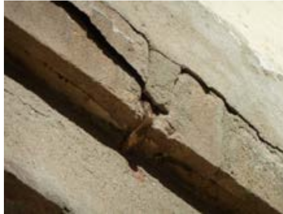
DESPRENIMENTS AL VOLTANT D'ELMENTS OXIDATS.
