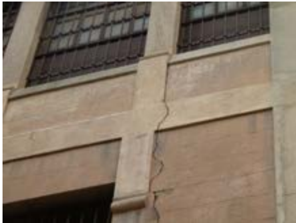
ESQUERDES IMPORTANTS EN ELS MURS DELS TESTERS DE LES GALERIES.
