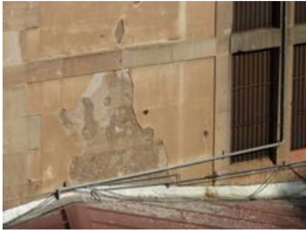
DESPRENIMENTS DELS ARREBOSSATS DE FAÇANA.
