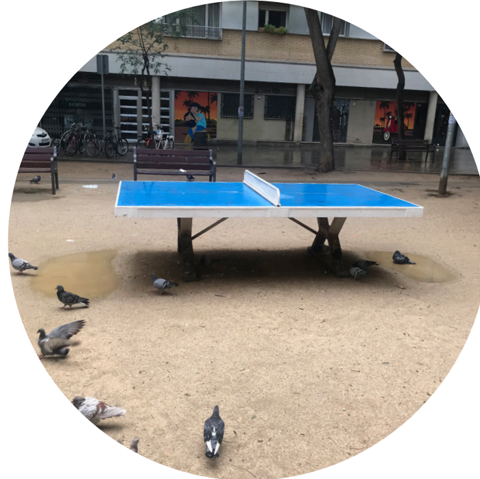
6 EROSIÓ DEL PAVIMENT DE SAULÓ Impacte de jocs infantils
