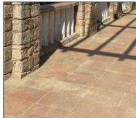
Degradació del paviment
