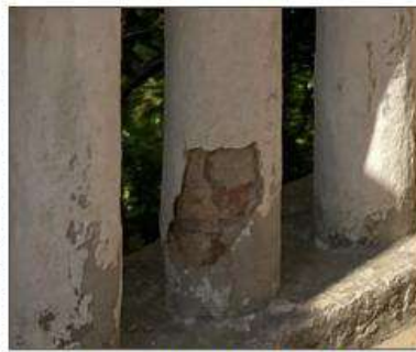
Z.1 - Pèrdua parcial del revestiment de morter i de la capa de pintura en elements verticals de la balaustrada, amb zones d'erosió que deixen el suport de pedra vist.
