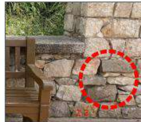
Pèrdua de material de rejuntat
