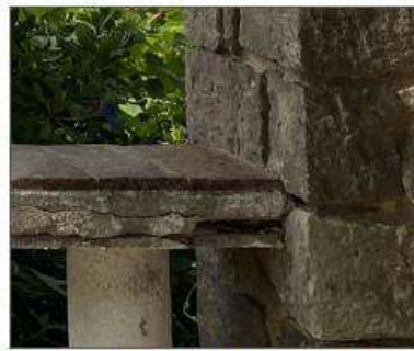
Z.2 - Oxidació i dilatació de l'armat del coronament de la balaustrada, amb fissuració i trencament del material ceràmic fins a deixar el metall al descobert, provocant esquerdes de continuïtat al pilar adjacent.
