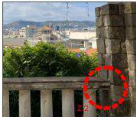
Esquerdes i trencament de la balaustrada
