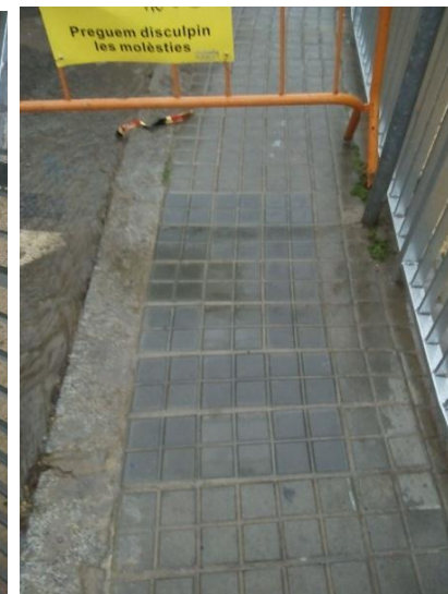
Estat després de l'actuació
