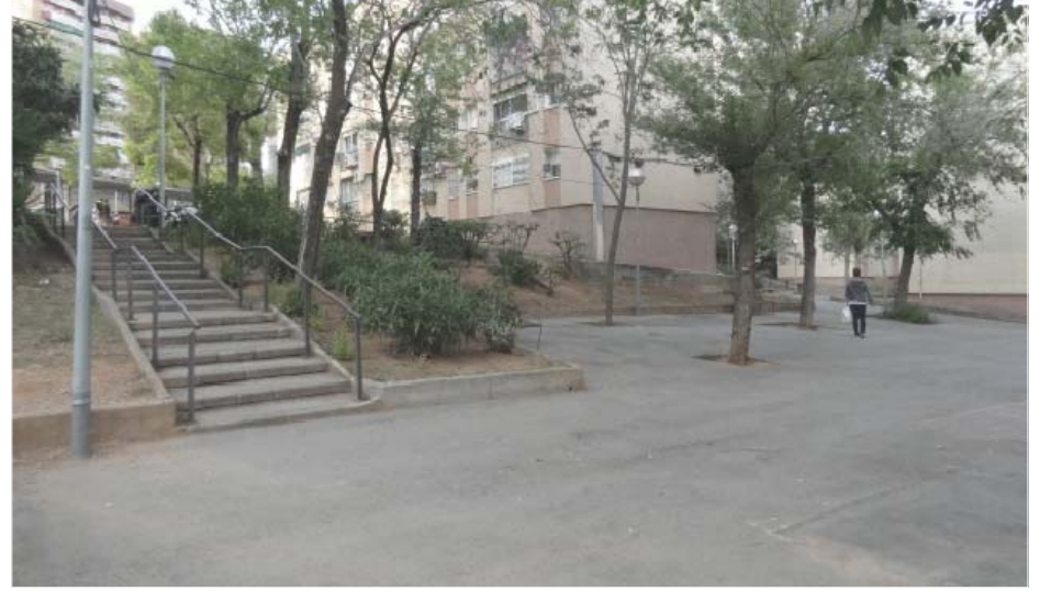
PERÍMETRES AMB TALUSOS AMB FORTS PENDENTS. PROBLEMES ESCORRENTIES
