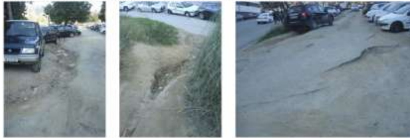
PAVIMENT EROSIONAT I MOLT DETERIORAT DEGUT A L'ACCIÓ DE L'AGUA I EL PAS DE VEHICLES
