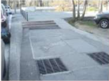
DISCONTINUITATS EN LA VORERA COM A CONSEQÜÈNCIA DE LA PRESENCIA D'UNA ESTACIÓ TRANSFORMADORA SOTERRADA
