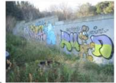
ZONES RESIDUALS AMB ACUMULACIÓ DE BRUTÍCIA I VEGETACIÓ DESCONTROLADA
