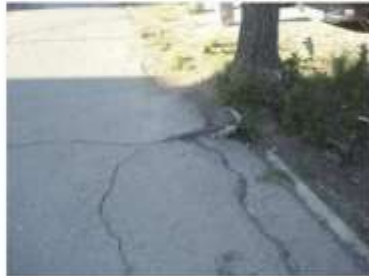
ADJECAMENT DE PAVIMENT A CAUSA DE LES ARRELS DELS ARBRES
