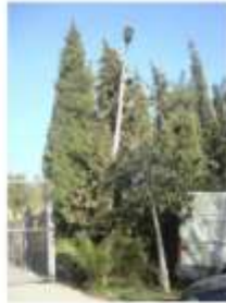
PUNTS DE LLUM EN PAL DE FUSTA EN MAL ESTAT
