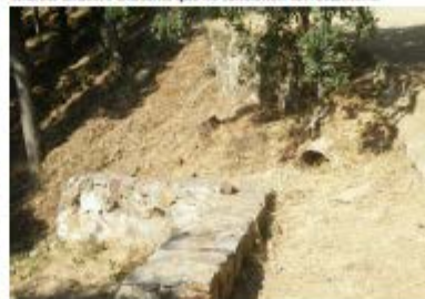
Murets difusors existents que no funcionen correctament.
